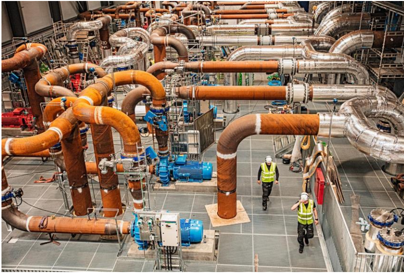
Figur 43: Havvandsvarmepumper er meget store systemer, da der arbejdes med parallelle systemer.
